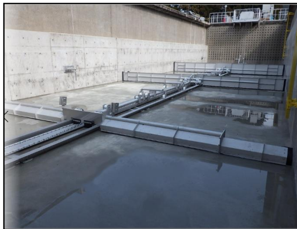
モノレール式汚泥掻寄機
