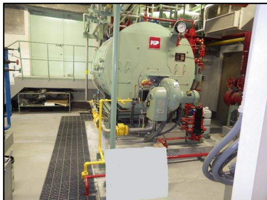
加温ボイラー
