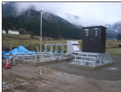
水源設備（水中うず巻ポンプ 125 A × 30kw × 1.443m 3 /min 棧側操作型屋外閉鎖自立型）
