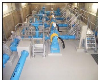
武生第一中継ポンプ場
