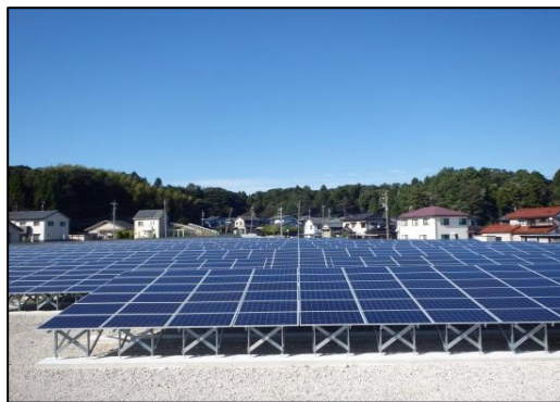
太陽光発電所
