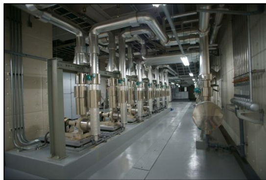
冷温水ポンプ 8 台 ヘッダー 4 基
