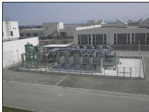
バイオマス（消化ガス）発電装置
